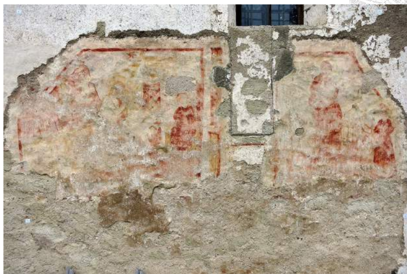
11. Východná časť výmalieb južnej fasády. Foto: restau.art, 2015.
