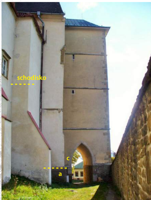
11 a) – b) Priebeh soklovej rímsy: a) pokračujúcej z južného ambitu, b) na juhozápadnom opornom pilieri, c) prerušenej prístavbou západnej veže kostola. Foto: N. Urbanová, 2015.
