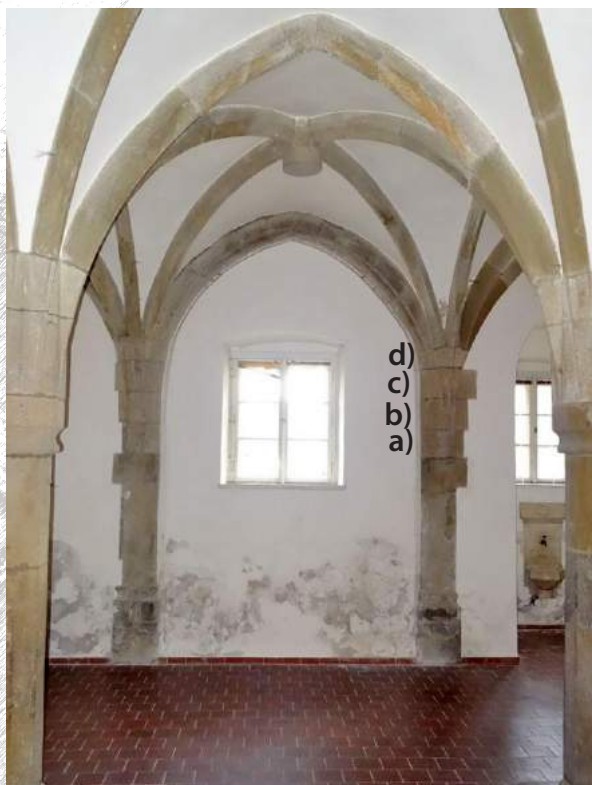
▶▶ 18. Konštrukcia tvaroslovia vstupu do priestoru kaplnky, južného medziklenbového pásu a východného klenbového rebra v južnom poli klenby má spoločnú a) podkružovanie pätku aj b) c) nábehy všetkých rebier spolu s d) ostentím vstupu. Foto: N. Urbanová, 2015.
